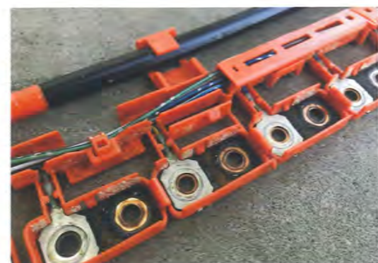
劣化状態 (ケーブル/タブピッチ)
